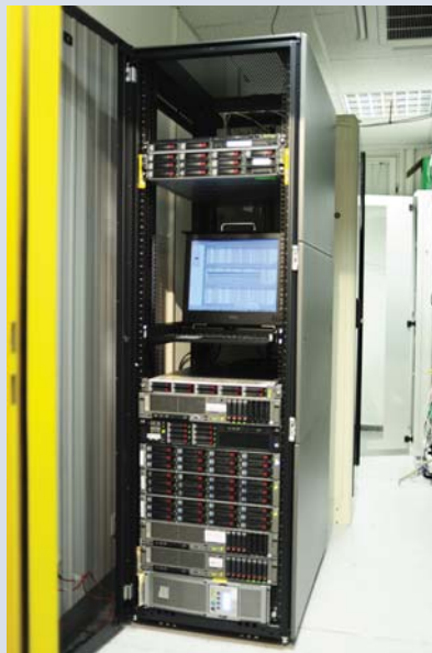
Dank Caching-Server können die Ärzte standortunabhängig arbeiten; das zentral gepflegte Sprachprofil sorgt für konstant hohe Erkennungsraten.
